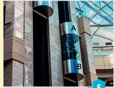
Cabines d'ascenseur en mouvement sur des rails
